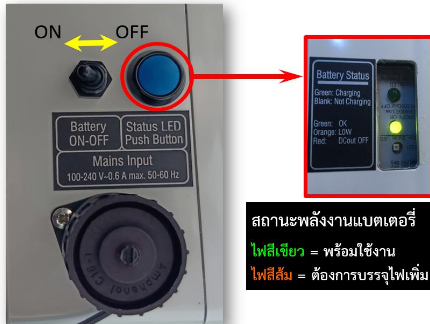
รูปที่ ๘๕ สวิทช์ตำแหน่ง เปิด-ปิด และปุ่มแสดงสถานะแบตเตอรี่
